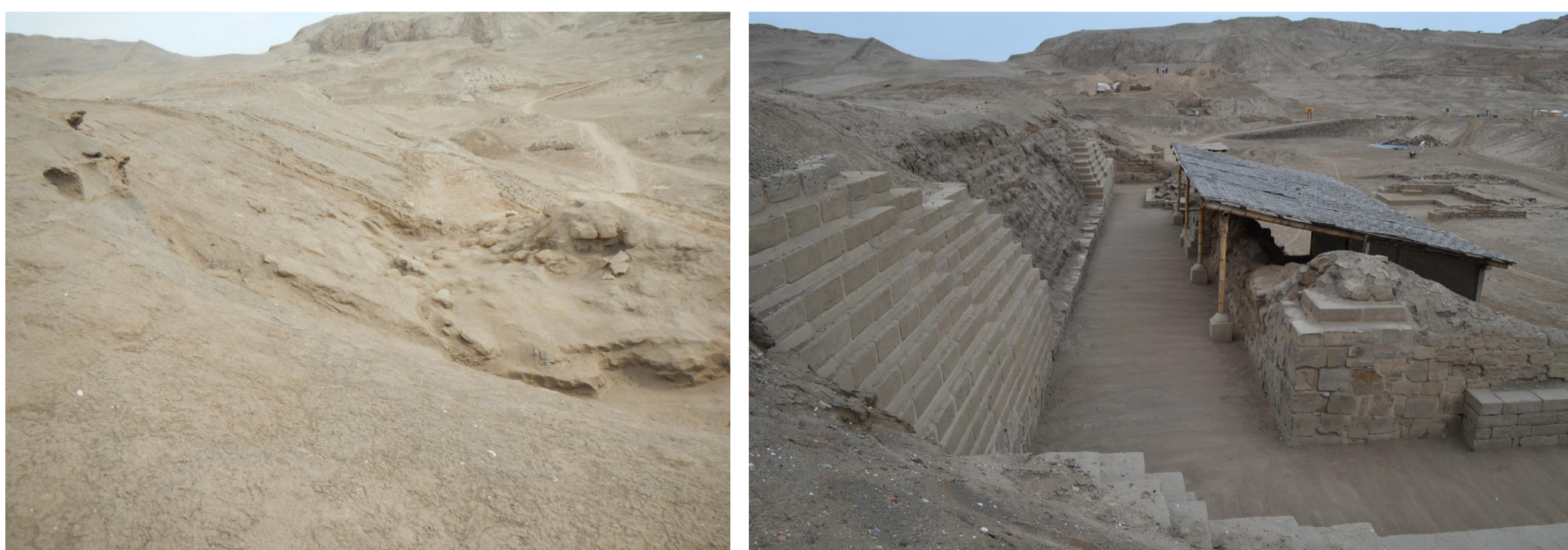
Trabajos de conservación del Pasadizo Este; antes y después de las intervenciones
